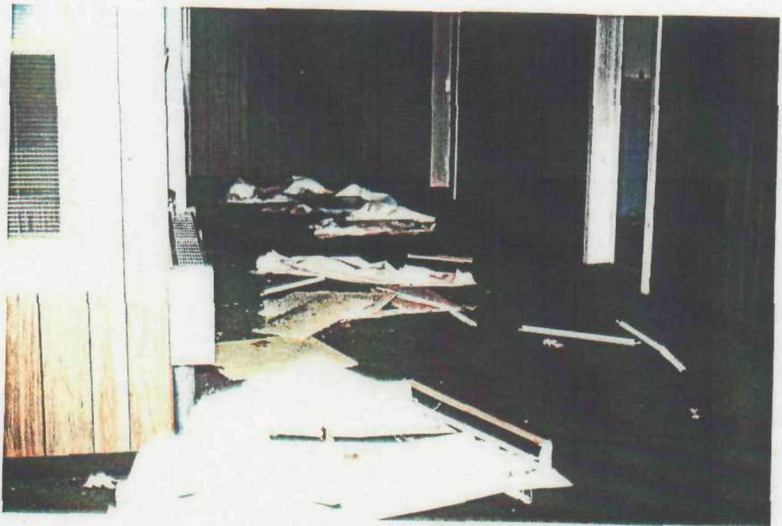
Vandalism, bldg. #P-7.
