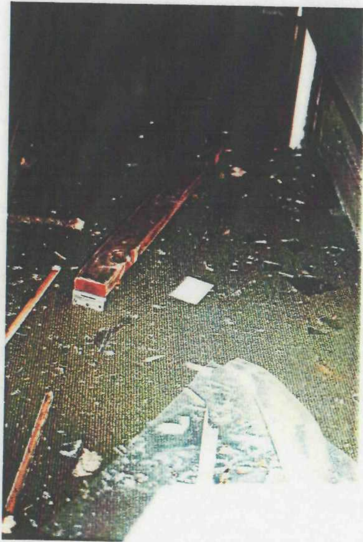
Vandalism, bldg. #P-7.
