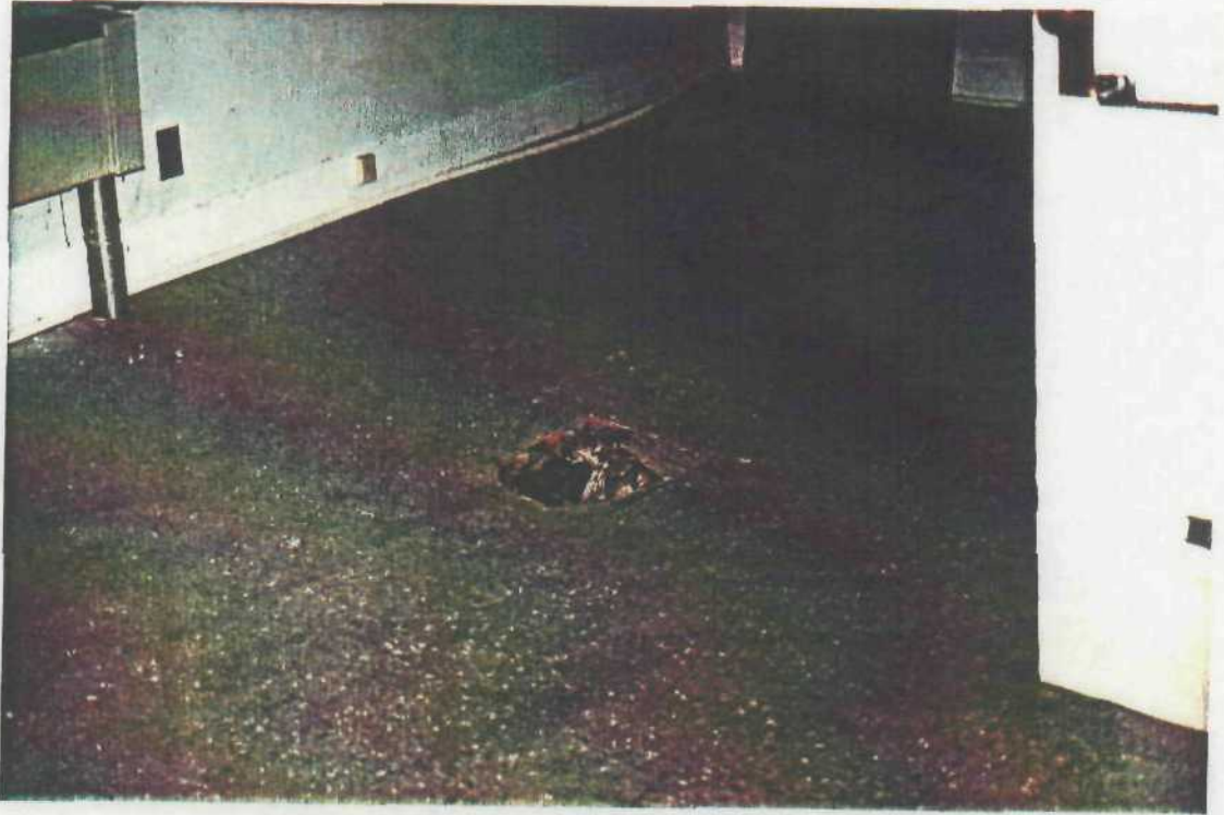
Sunken, damaged floor, bldg. #P-7.
