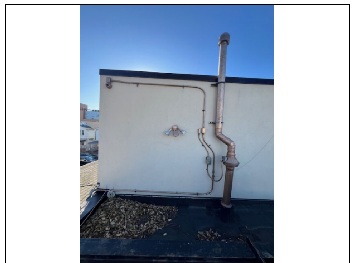
12. SSDS Fan on the Roof
