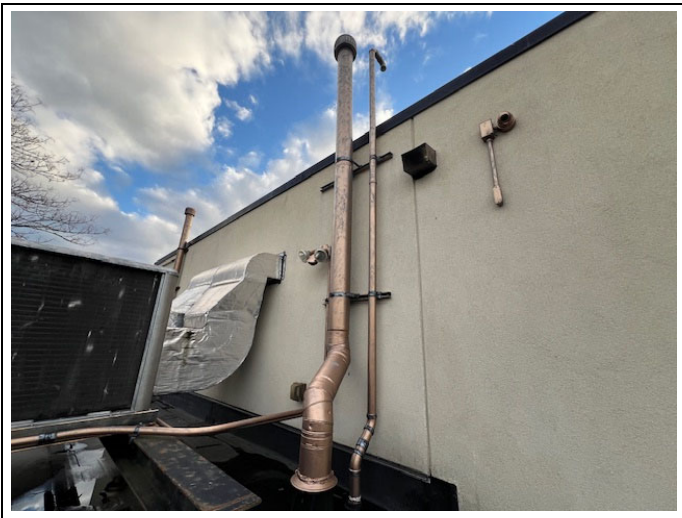
3. SSD Riser Pipe
