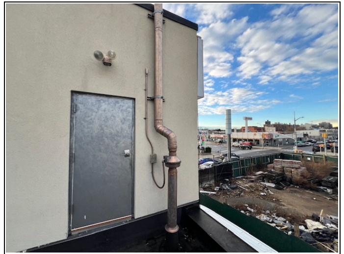
4. SSD Riser Pipe
