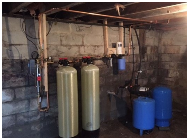
Un Sistema de POET instalado en un pozo privado
