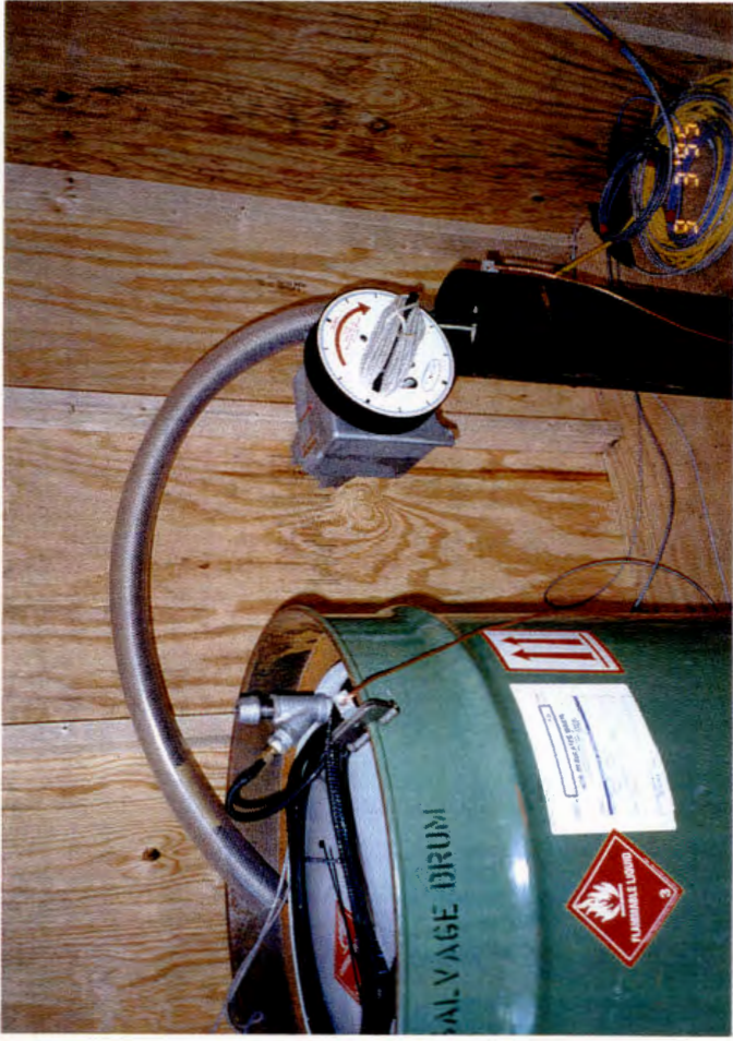
2) Product storage drum and ALS reel affixed to well head.
