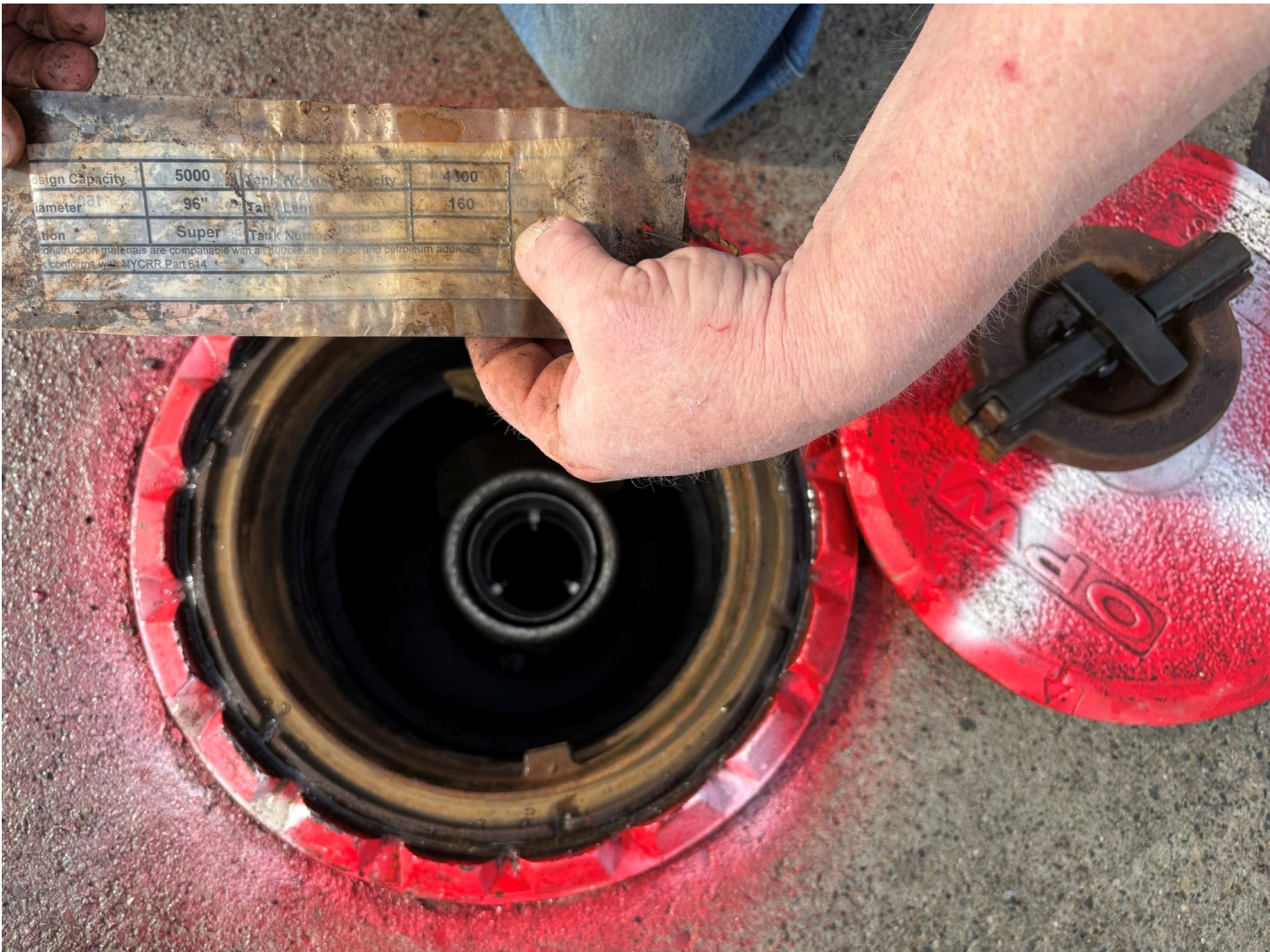
Tank 01A Fill port
