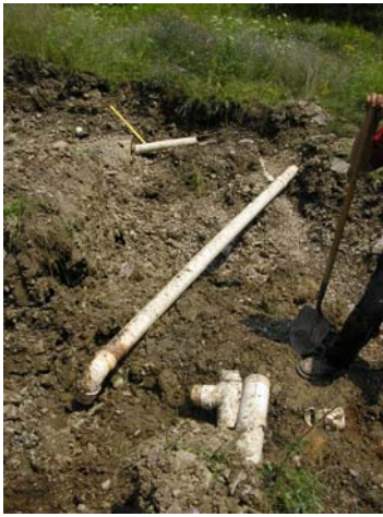
ik BBT1 North Repair 6.J
