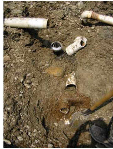
ik BBT1 North Repair 7.J
