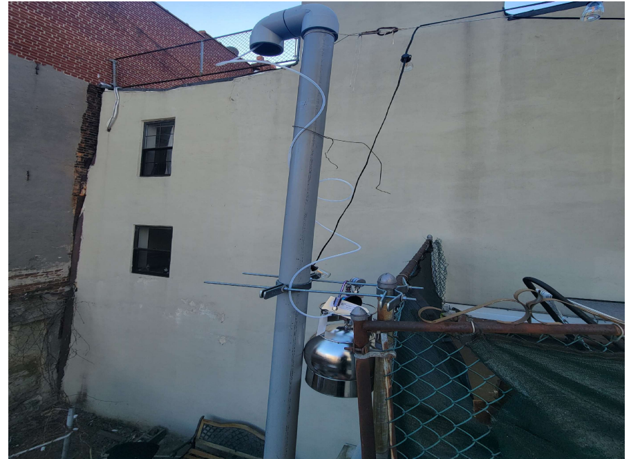
SSDS effluent air sampling
