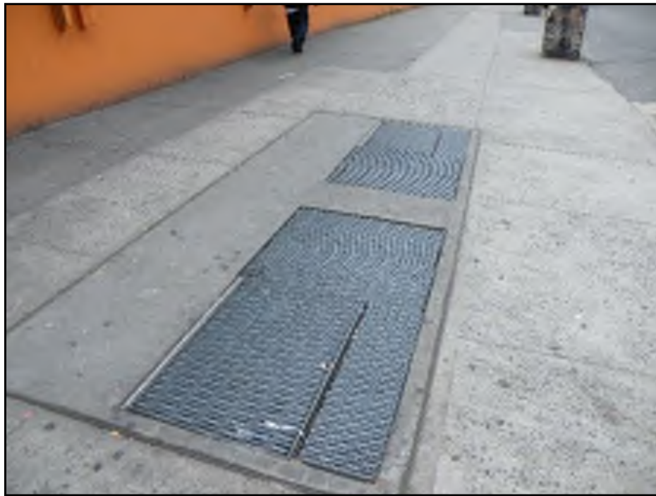
Con Edison transformer vault
