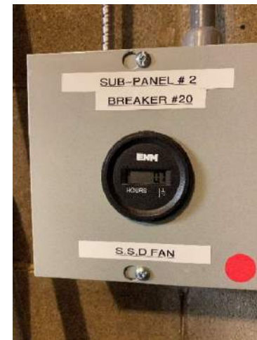
Photo 4: SSDS Fan Hour Meter
