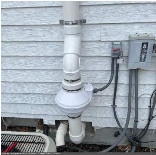
Photo 1: SSDS Fan Unit
