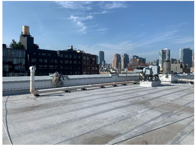
Effluent Stack on Roof
